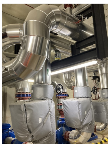
Pompes et tuyauteries
