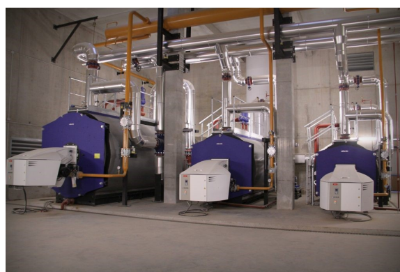
Les trois chaudières gaz d'appoint
